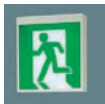
避難口誘導灯
